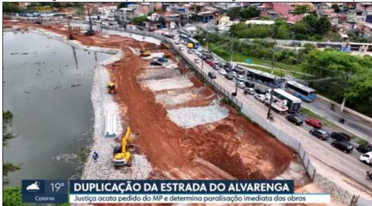
Foto 5 – Vista geral das obras de duplicação da Estrada do Alvarenga no trecho de 450m com o aterro provisório
